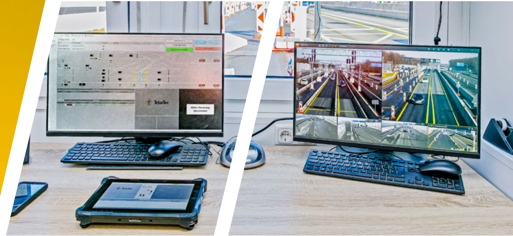
Am PC lässt sich die vollautomatische Ausleitung der Fahrzeuge überwachen.
