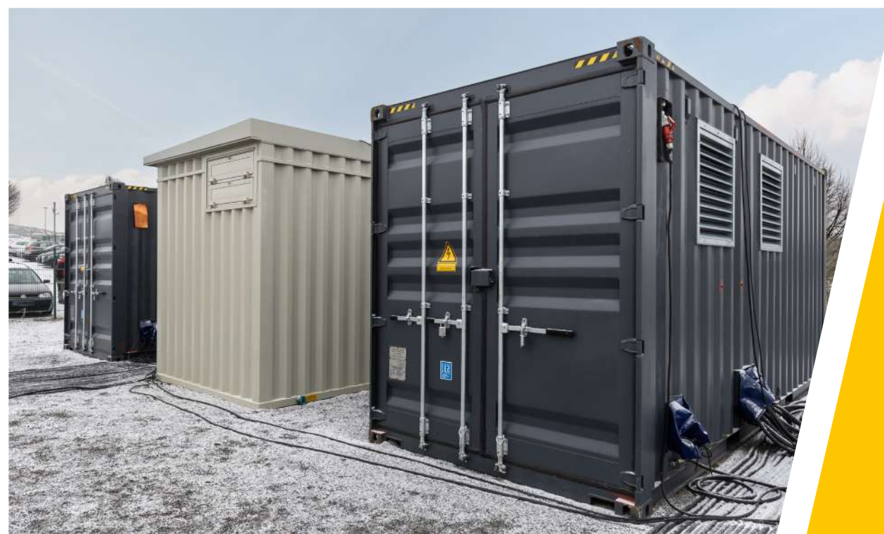
Die kundenseitig vorhandenen Transformatoren wurden von Zeppelin Rental in spezielle 20 Fuß Container verbaut
