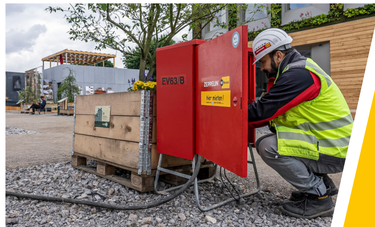
Zeppelin Rental übernahm die Stromversorgung auf dem Gelände
