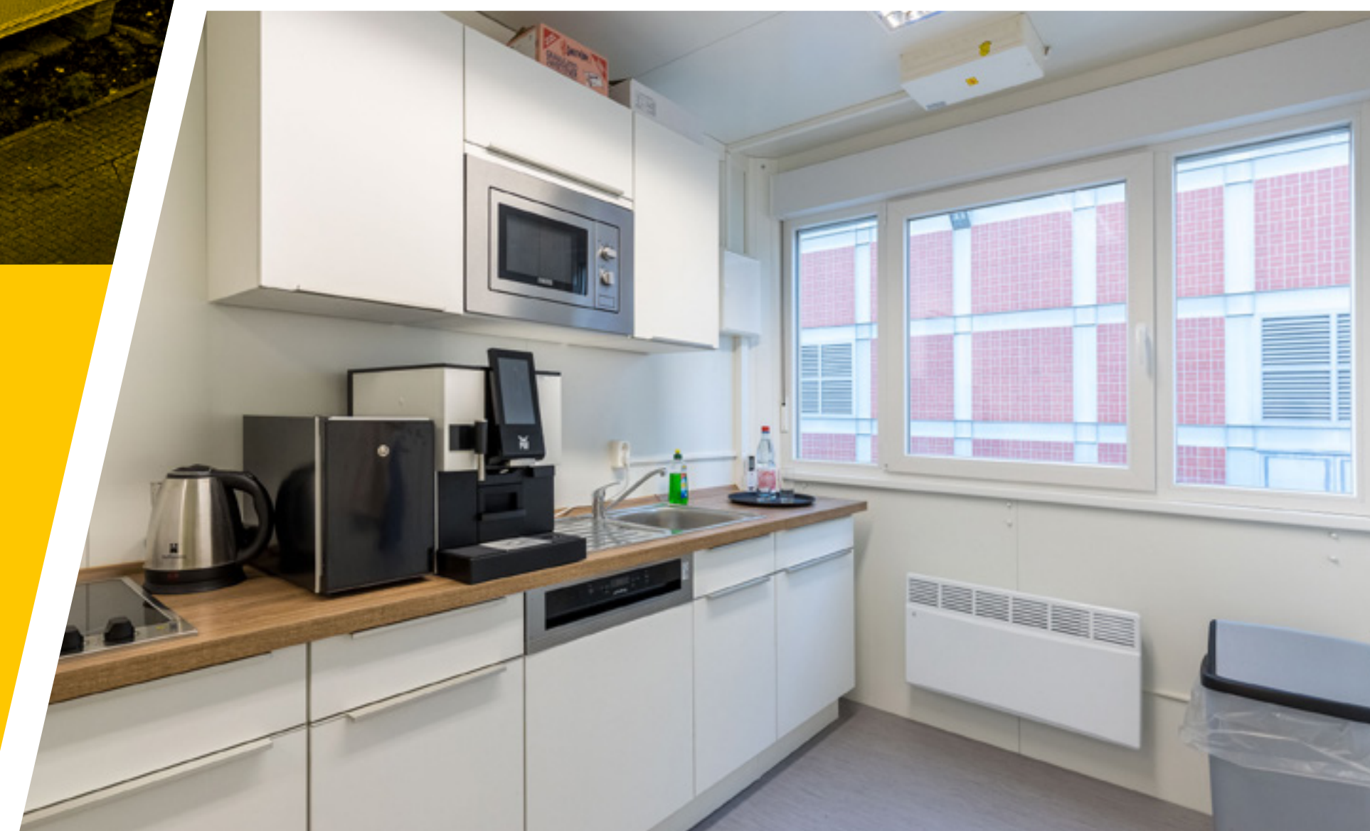
Insgesamt vier Küchen wurden entsprechend der Kundenvorgabe geliefert und installiert
