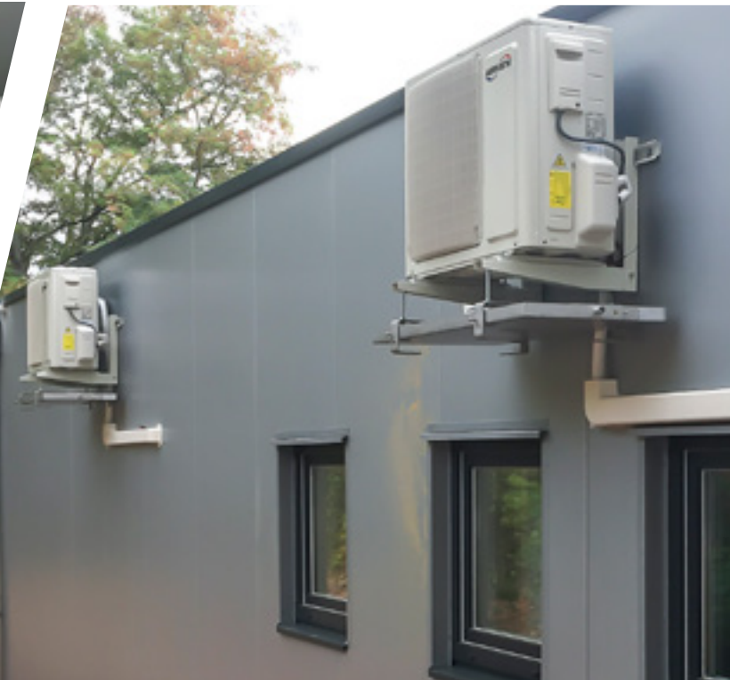
Split-Klimageräte regeln das Raumklima
