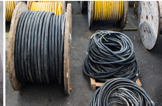
Für das Bauvorhaben wurde ein fünfadriges TNS-Netz eingesetzt.
