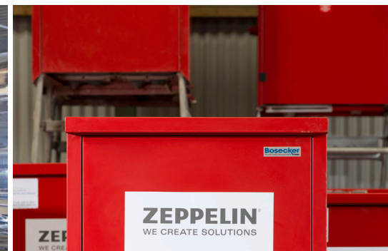
Service vor Ort: Die Elektriker reagierten jederzeit auf Störungen.
