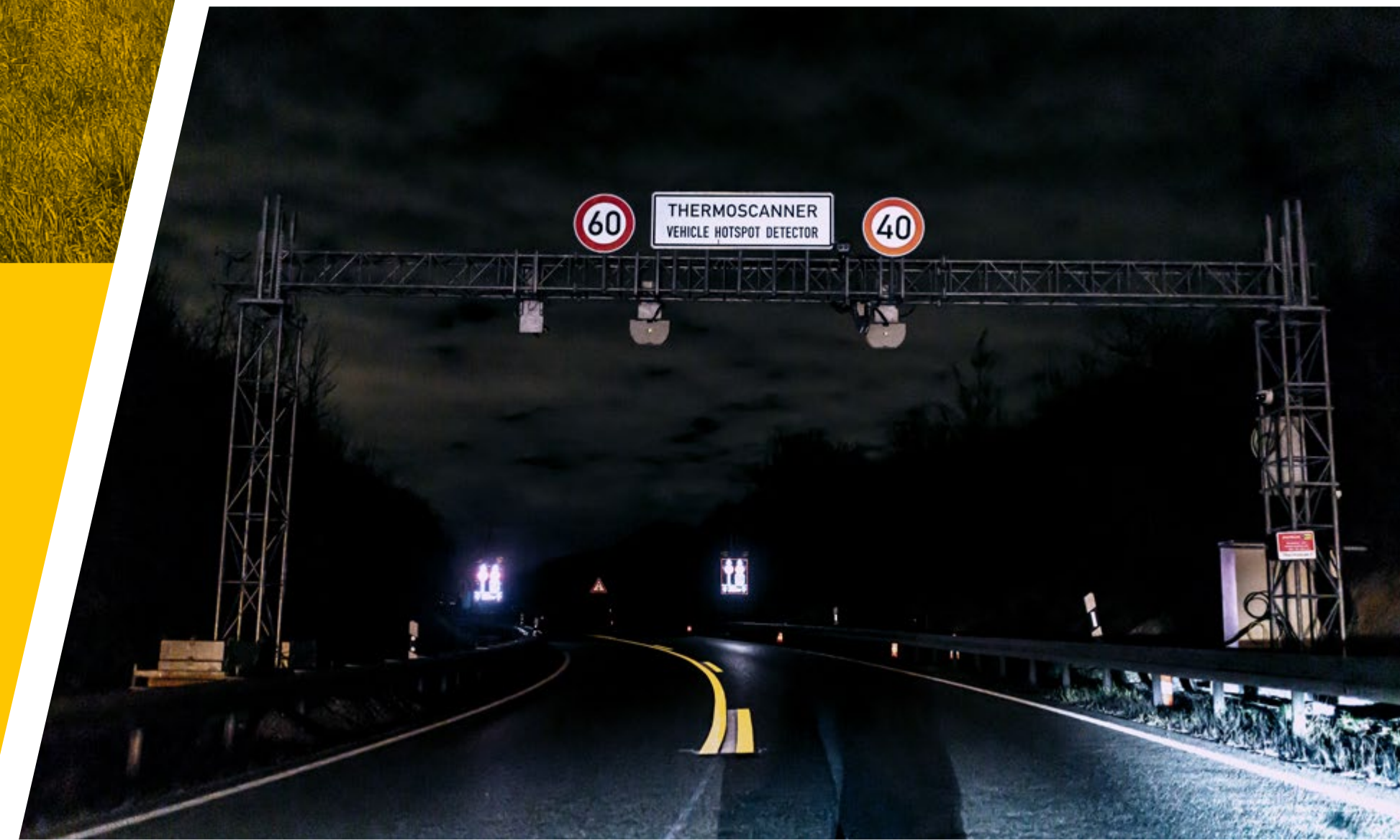
Ein Thermoscanner, montiert auf einem mobilen Portal, prüft Gefahrguttransporter auf überhitzte Fahrzeugteile
