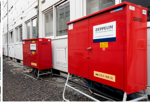
Insgesamt wurden 150 Verteilerschränke, rund 15 Kilometer Kabel, 930 Lampen und 30 Flutlichtstrahler installiert.
