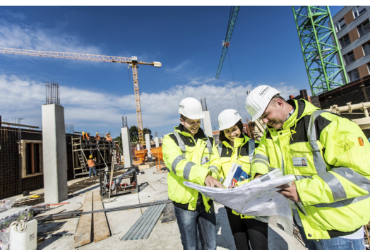
Bei dem Bauvorhaben mitten auf dem Klinikum-Campus ist eine genaue Logistikkoordination besonders wichtig.
